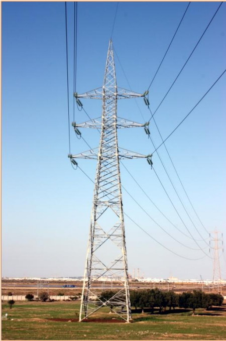
Ligne 225 kV Rades-Naassen
