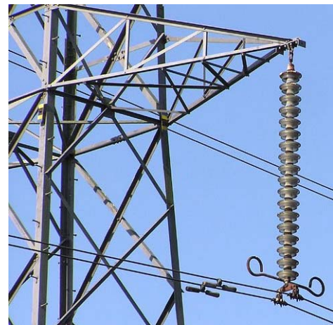
Figure 37 : Chaîne d'isolateurs sur un pylône de THT.
