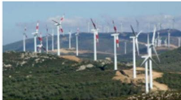
Parc éolien de Tanger
